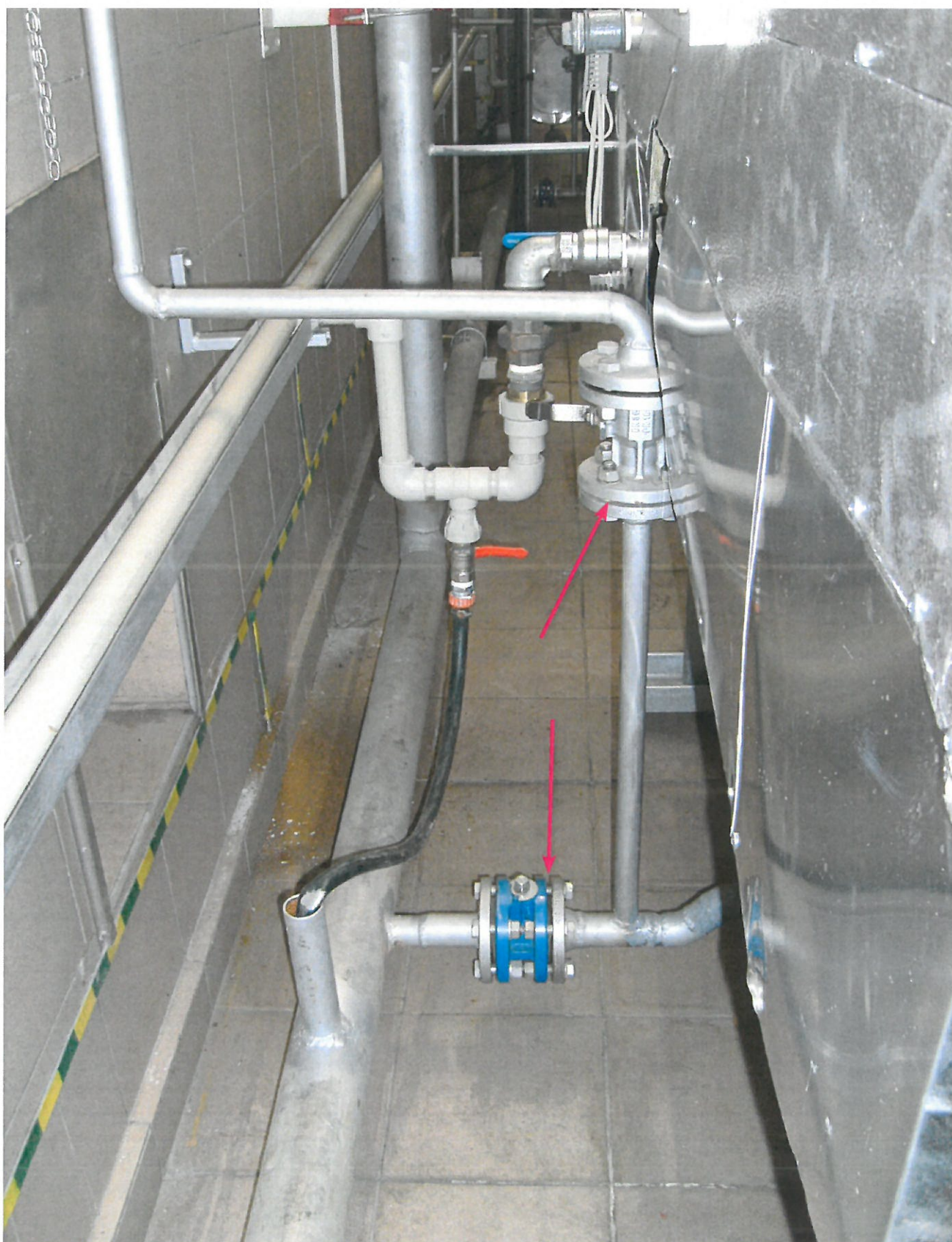
Dodatkowa armatura w rejonie odwodnienia kotła umożliwiająca jego pełne naładowanie
