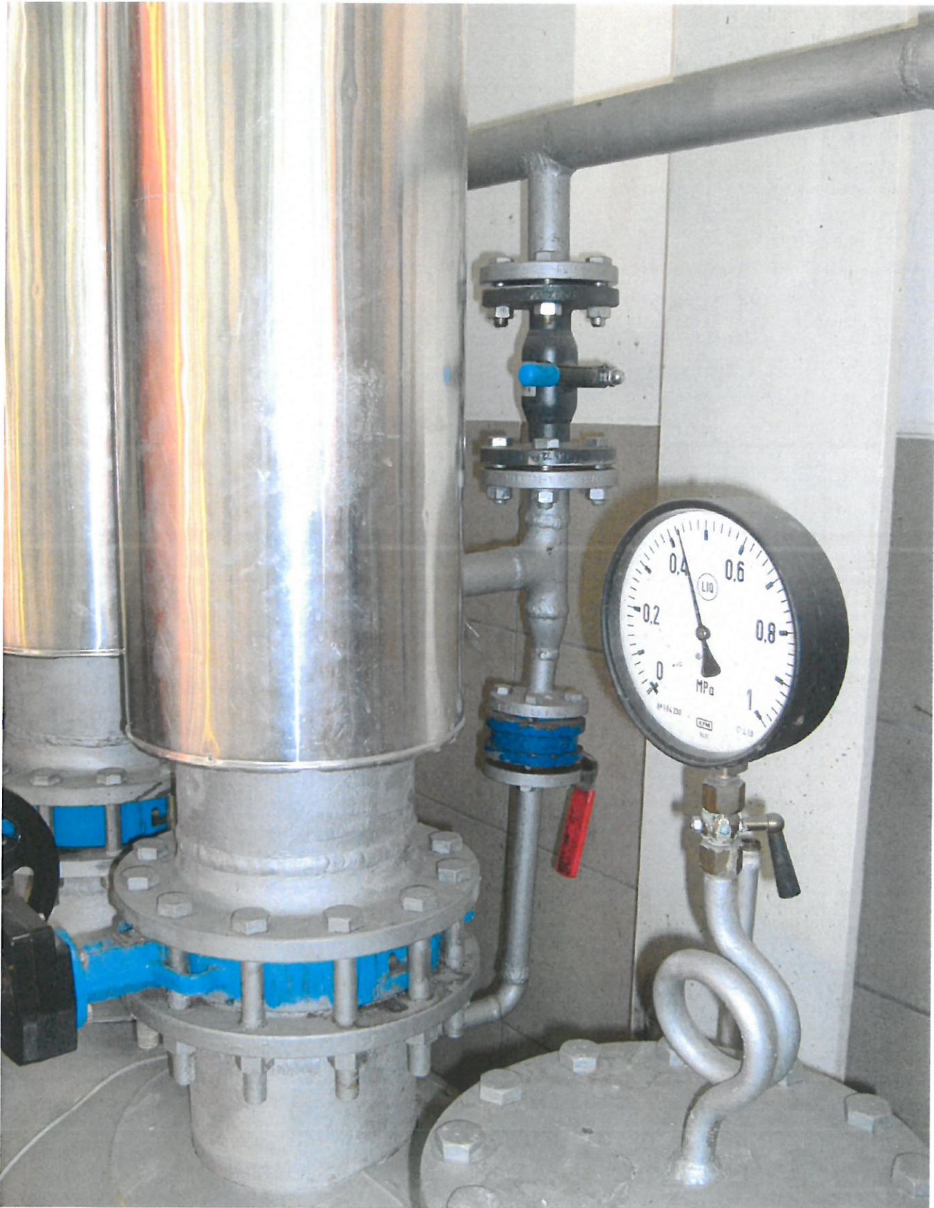
Dodatkowa armatura na kolektorze wlotowym do kotłów
