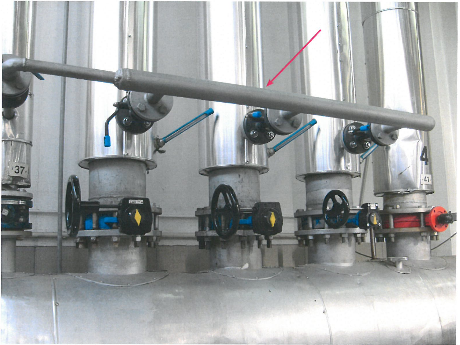
Dodatkowy kolektor na wylocie z kotłów umożliwiający ładowanie 2 kotłów w czasie pracy jednego kotła
